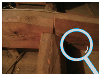
接合部調査: 金物はあるが錆びている
