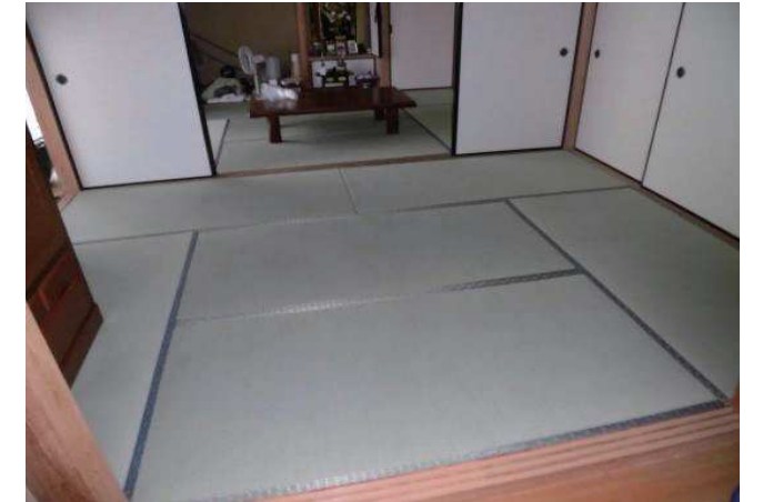
既存床組が傷んでいたため補強し畳を新調。襖も張替えすっきりした印象に。
