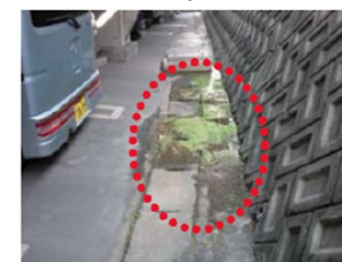
湧水部分にコケが生えている擁壁
