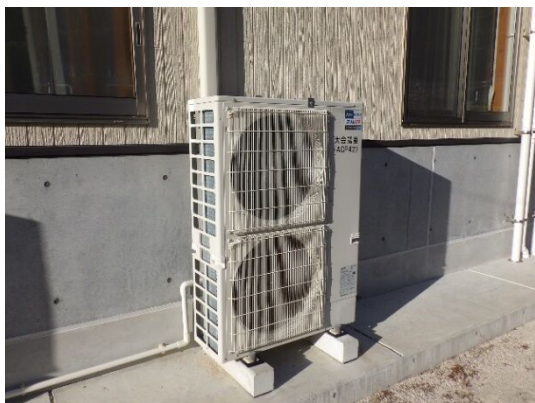
ヒートポンプ式空調設備(笠戸公民館)
