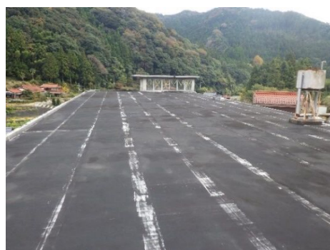
屋上防水の劣化
