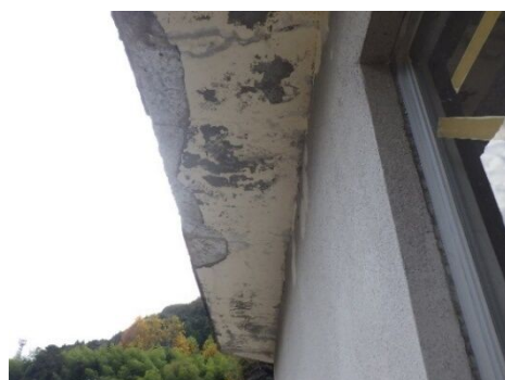
軒裏モルタルの剥落
