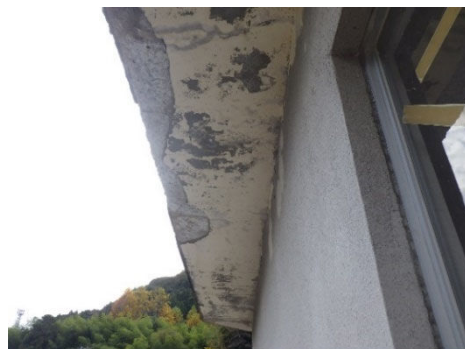
軒裏モルタルの剥落
