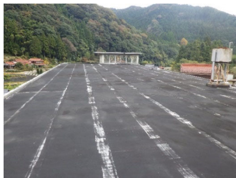
屋上防水の劣化
