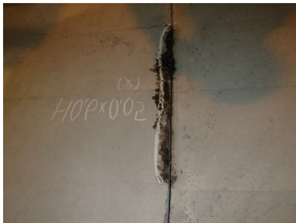
目地部のはく離(たたき落とし前)(S-014 アーチ部)
