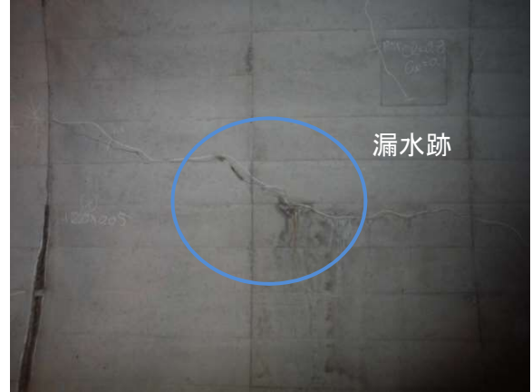
側壁のひび割れ状況(S-005 上り側)
