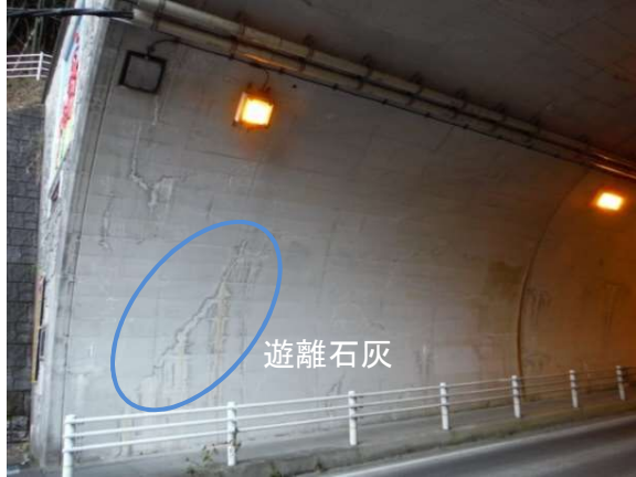
側壁のひび割れ状況(S-001 下り側)
