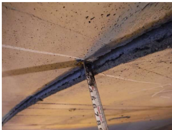
目地部の段差(S-001 アーチ部)
