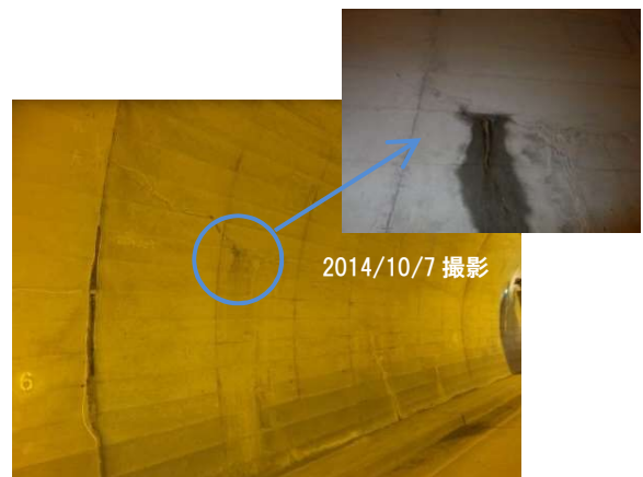
漏水跡の変状(S-005 側壁部 上り線)
