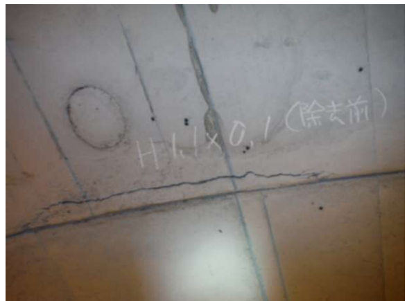
目地部のはく離(S-010 側壁部)
