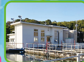
塩素注入設備
