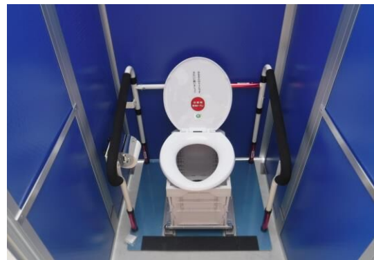
(設置例：花岡公民館、令和4年度設置)
