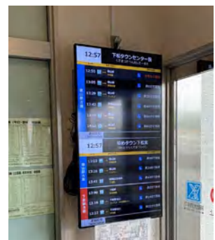
デジタルサイネージ の設置
