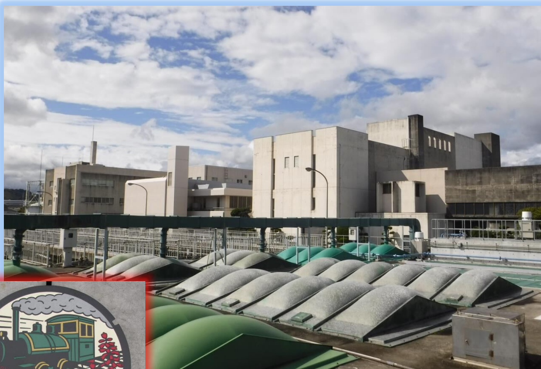
下松市浄化センター
