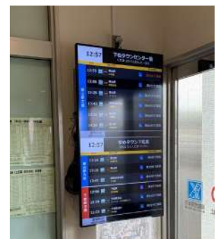
デジタルサイネージ の設置
